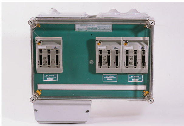
Verteiler mit 3x NH-Reiter-Sicherungslasttrenner NH00
