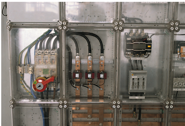
Lasttrennschalter in einer Verteilung
